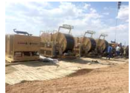
Freineuses jumelées avec cabestans Ø 2 m démontables, pour déroulage faisceau sextuple
